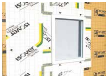
Liaison de la bande de membrane Vario® Xtra avec Vario® Xtra Band en entourage de fenêtre
